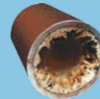
▲ 处理前的管道
